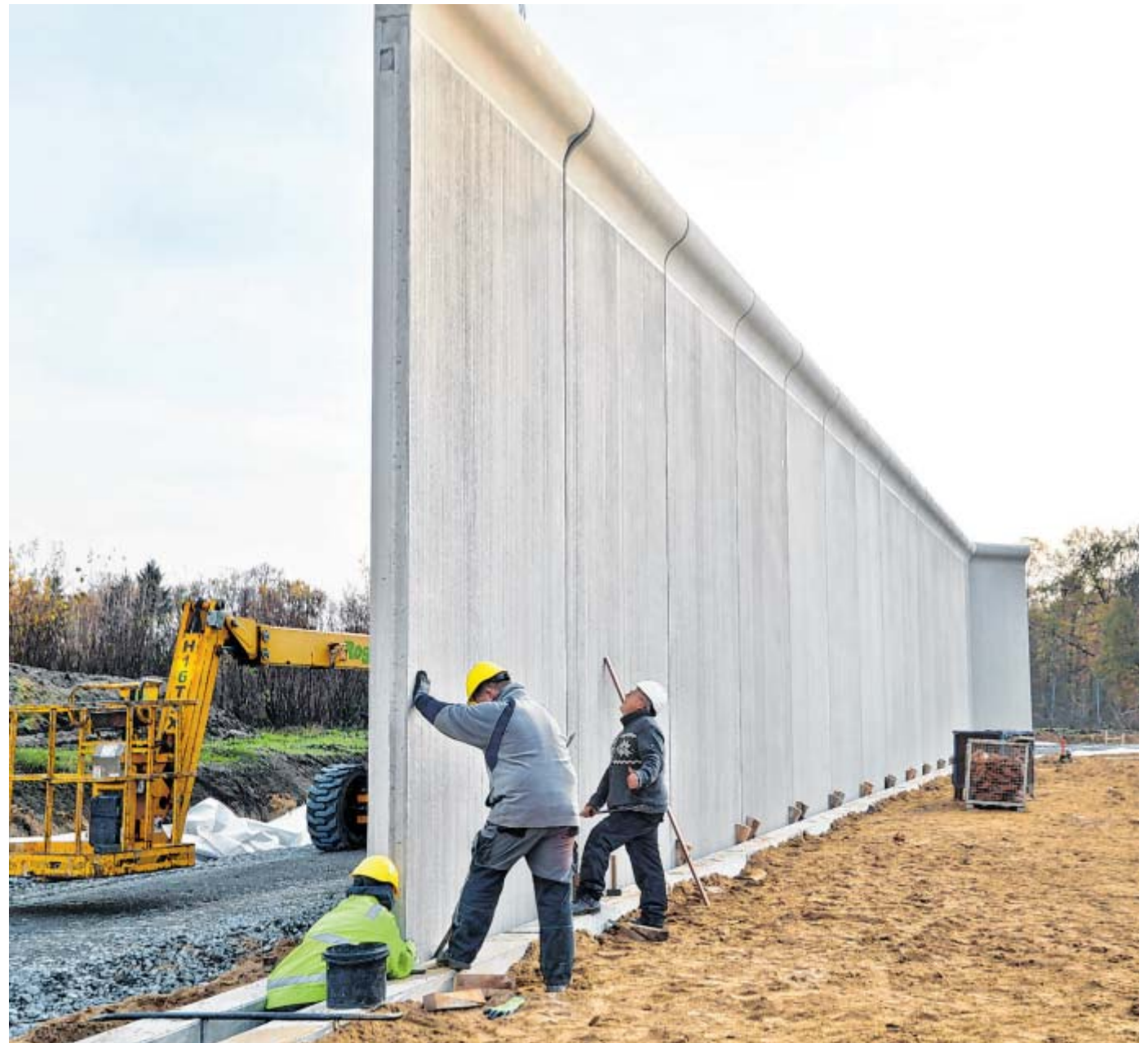
Die neue Mauer: Die Begrenzung des Anbaus wird 330 Meter lang und fünf Meter hoch sein. Die Errichtung der Mauer, die aus zahlreichen zehn Tonnen schweren Einzelteilen besteht, soll im Dezember abgeschlossen werden.
